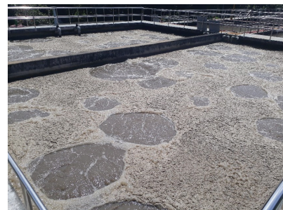
Figura 1. Tanque de lodos activados. Fuente: Autor
